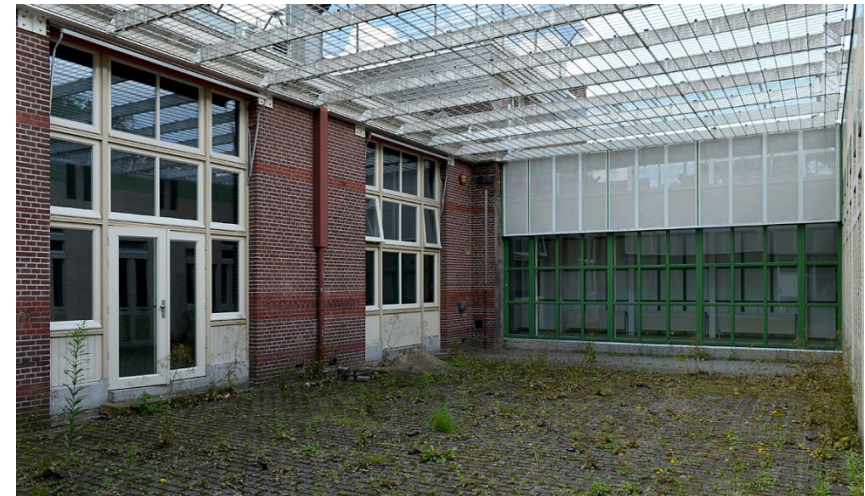
59. Zeist, (vm.) Justitiële Jeugdinstelling Eikenstein, zuidwestelijke luchtplaats; links de puien in de westgevel van de westvleugel, die in de jaren 1960 zijn gewijzigd en na 2006 weer, bij de vernieuwing van ramen en deuren, 2020 ( De Fabryck ).
