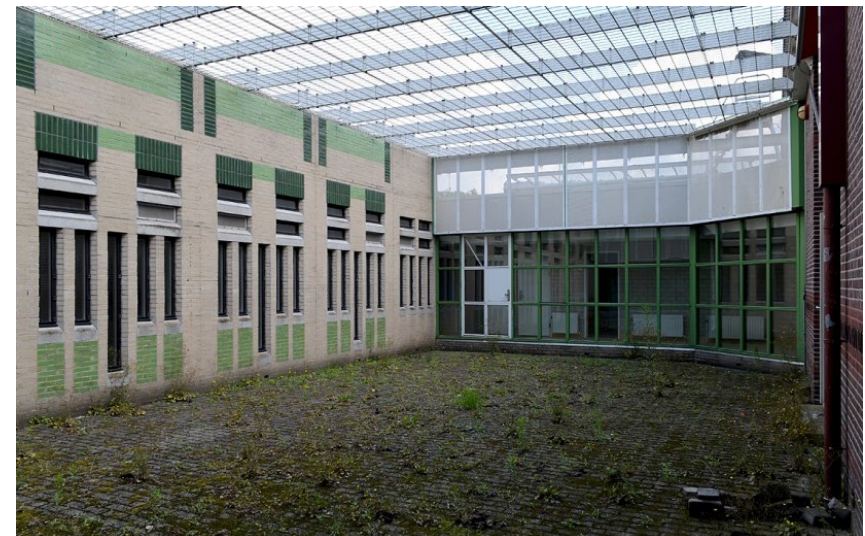
60. Zeist, (vm.) Justitiële Jeugdinstelling Eikenstein, zuidwestelijke luchtplaats vanuit het zuidoosten, met zicht op de cellenvleugels en de verbindingsgangen uit 1987-1989, 2020 ( De Fabryck ).
