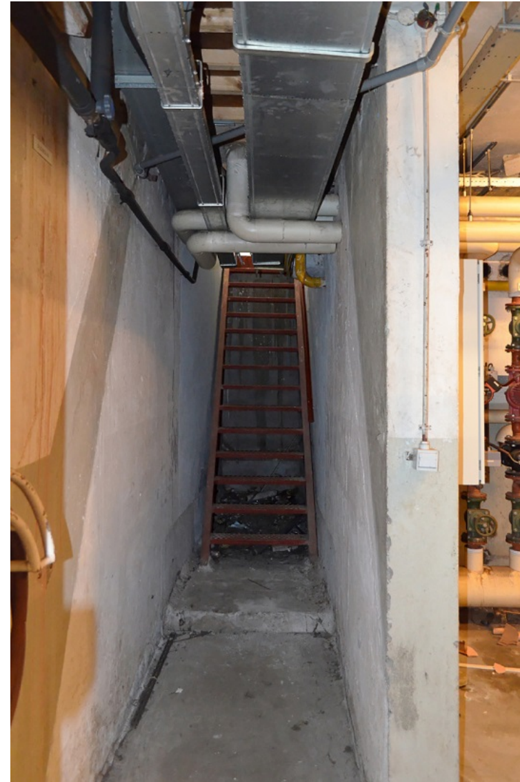
132. Zuidvleugel, kelder onder hoofdgebouw (1904-1905), de in 1998 in oostelijke richting verschoven en vernieuwde trap.
