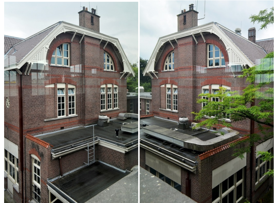
104. Zuidvleugel, noordbeuk, bovenzijde vanuit het noordoosten; het gedichte segment van het oostelijke venster op de verdieping is oorspronkelijk.
