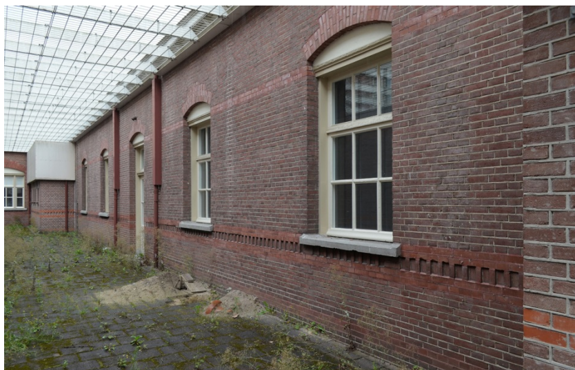
117. Noordvleugel, zuidgevel aan de centrale luchtplaats vanuit het oosten; de vensters dateren volledig van uit 1908-1909.
