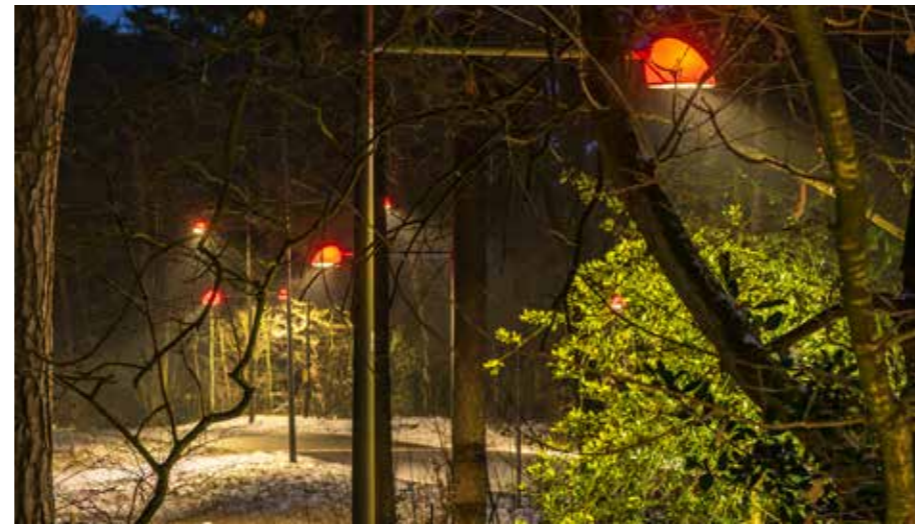
HERKENBARE MASTEN EN ARMATUREN LANGS DE KERCKEBOSCHLAAN
