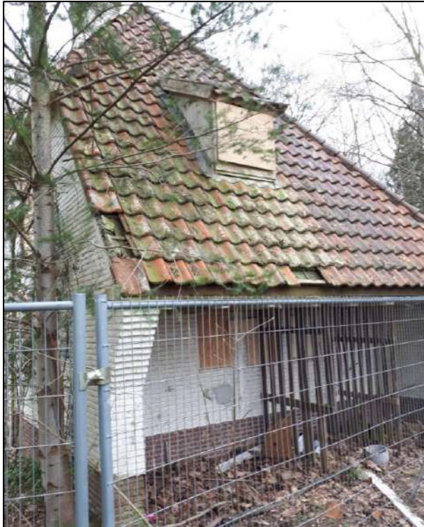
Figuur 4.3 Losse dakpannen en kieren onder gevelpannen dienen mogelijk als invliegopening voor vleermuizen. Foto: Arjan van Vuuren, Ecogroen.
